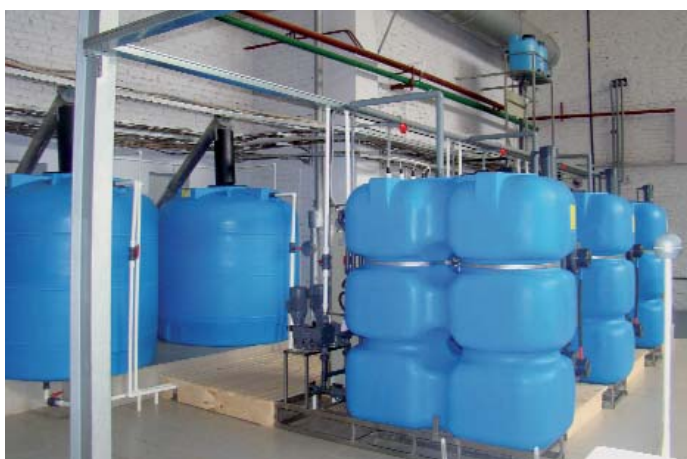
Электролизные установки ЭПМ-50
